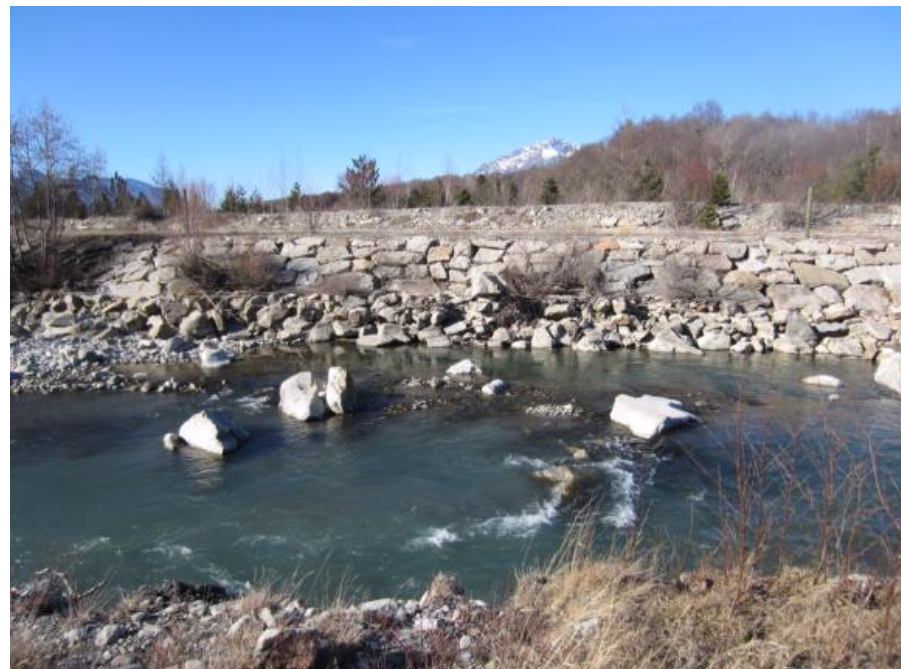
Digue et protection de berge du plan d'eau affouillés
